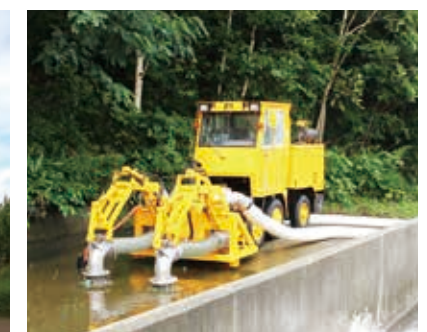
■ 排水ポンプ装置
